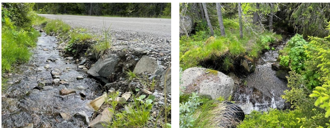
FIGUR 9 BJØRGEBEKKEN NORD: EROSJONSSKADER PÅ VEG T.V. OG KULP OG BRATT TERRENG NEDSTRØMS T.H.
