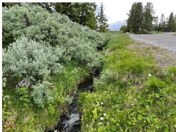
FIGUR 22 BILDE OMRÅDE G: VEGEN ER TIDLIGERE ETABLERT UT I BEKKEN OG BEKKEN FRAMSTÅR NÅ SOM EN KANALISERT GRØFT. KRAFTIGE VIERKRATT PÅ SIDEN SOM KAN BENYTTES I RESTAURERINGSARBEID.
