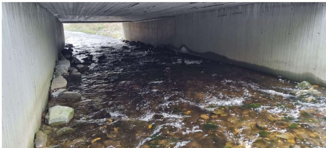
Figur 6: Masseavsetning i E6 kulvert under dagens forhold. Foto: Norconsult 2022.10.04.
