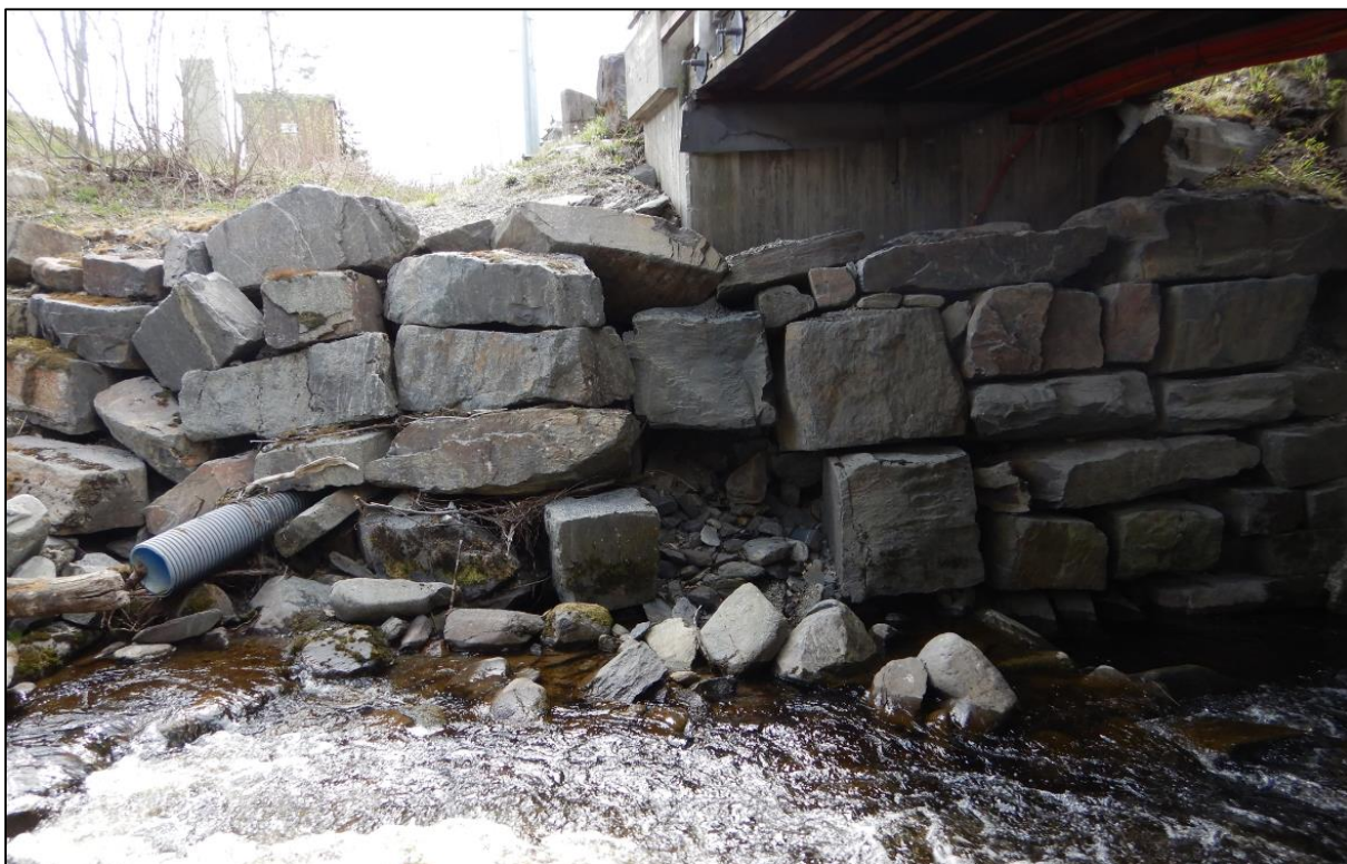
Figur 20: Skader på tørrmur under Bru Kongsvegen.
