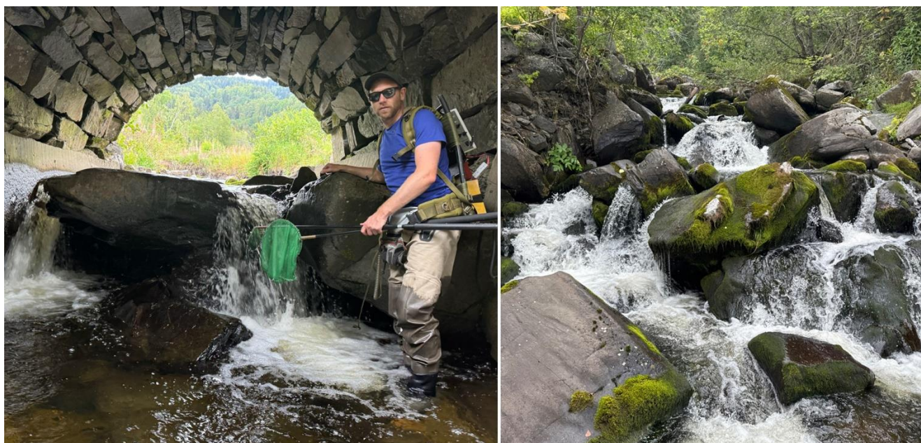
Figur 11. Vandringshinder 10 (t.v.) og 11 (t.h.) i Søre Brynsåa. Vandringshinder 10 (bru Gamlevegen) har betydelig fall og utgjør muligens et absolutt vandringshinder. I denne utredningen er imidlertid teoretisk absolutte vandringshinder satt noe lenger oppstrøms der gradienten stiger markant og definitivt umuliggjør videre vandring.
